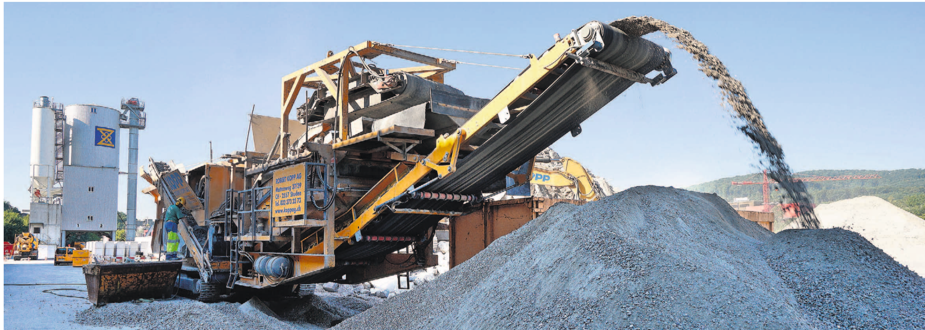
Die Betonbrechmaschine liefert, je nach eingesetztem Sieb, die gewünschte Körnung für verschiedene Anwendungen von der Strassen-Koffierung bis zum Konstruktionsbeton für Wände.
